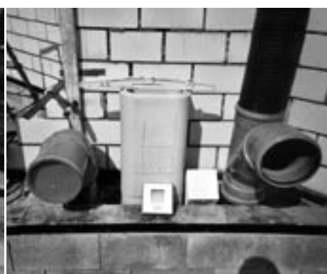
KANAAL 1 (LINKS): DE GRONDBUIS, KANAAL 2 (MIDDEN): HET ROOKGASKANAAL EN KANAAL 3 (RECHTS): AANVOER VAN VOORVERWARMDE VERSE LUCHT AFKOMSTIG VAN EEN LUCHTCOLLECTOR.
