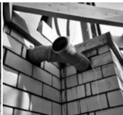
DE VENTILATIEAFVOER BOVENAAN KANAAL 1.
