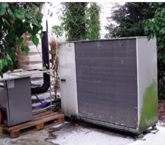
EEN LUCHT/WATER WARMTEPOMP DIE SCHROMELIJK TEKORT SCHOOT TIJDENS DE WINTER 2009-10. EEN CV-KETEL OP STOOKOLIE MOET BUITEN IN WEER EN WIND DE WARMTEPOMP WAT BIJSPRINGEN. WIE KAN NOG VOLGEN?
