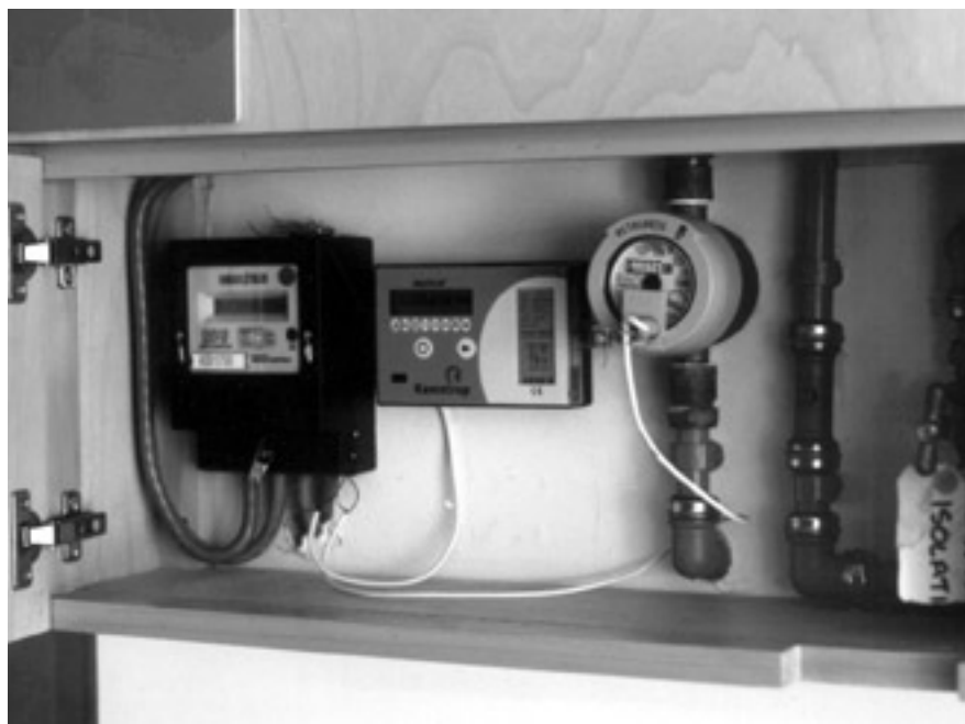
ALLE VERBRUIKSMETERS (WATER, ELEKTRICITEIT EN AFGENOMEN WARMTE) ZIJN ZICHTBAAR OPGESTELD IN DE KEUKEN ZODAT DE GEBRUIKER VOELING KRIJGT MET ZIJN EIGEN CONSUMPTIEGEDRAG.
