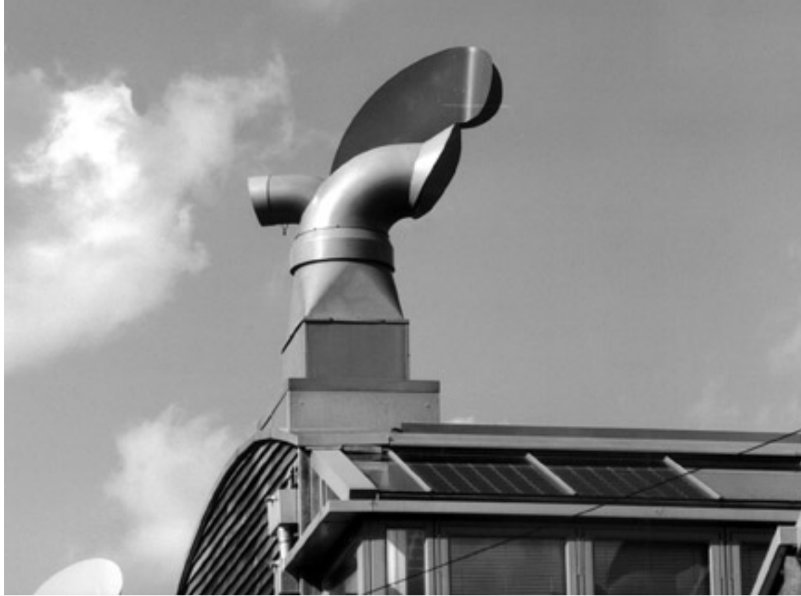
DE BLIKVANGERS VAN HET PROJECT ZIJN DE ENERGIELOZE, DOOR DE WIND AANGEDREVEN, VENTILATIESCHOUWEN (WIND COWLS) DIE EEN LEUKE ARTISTIEKE 'TOUCH' MEEKREGEN.
